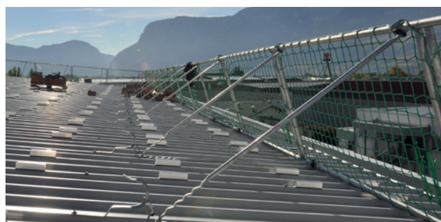
Per la sicurezza in quota: Telaio con rete di protezione
