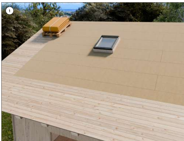
1 Colocar la paleta que contiene la membrana plegada en la parte superior del faldón a cubrir
